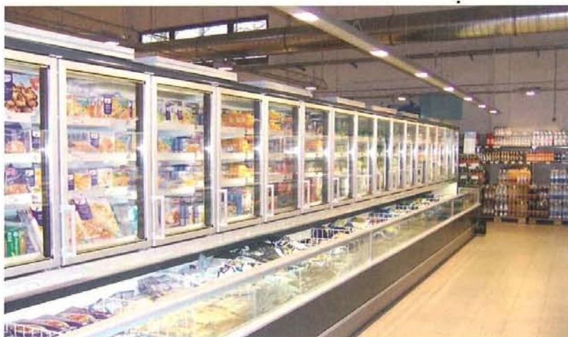
Tiefkühlmöbel in einem „tegut...“-Markt
