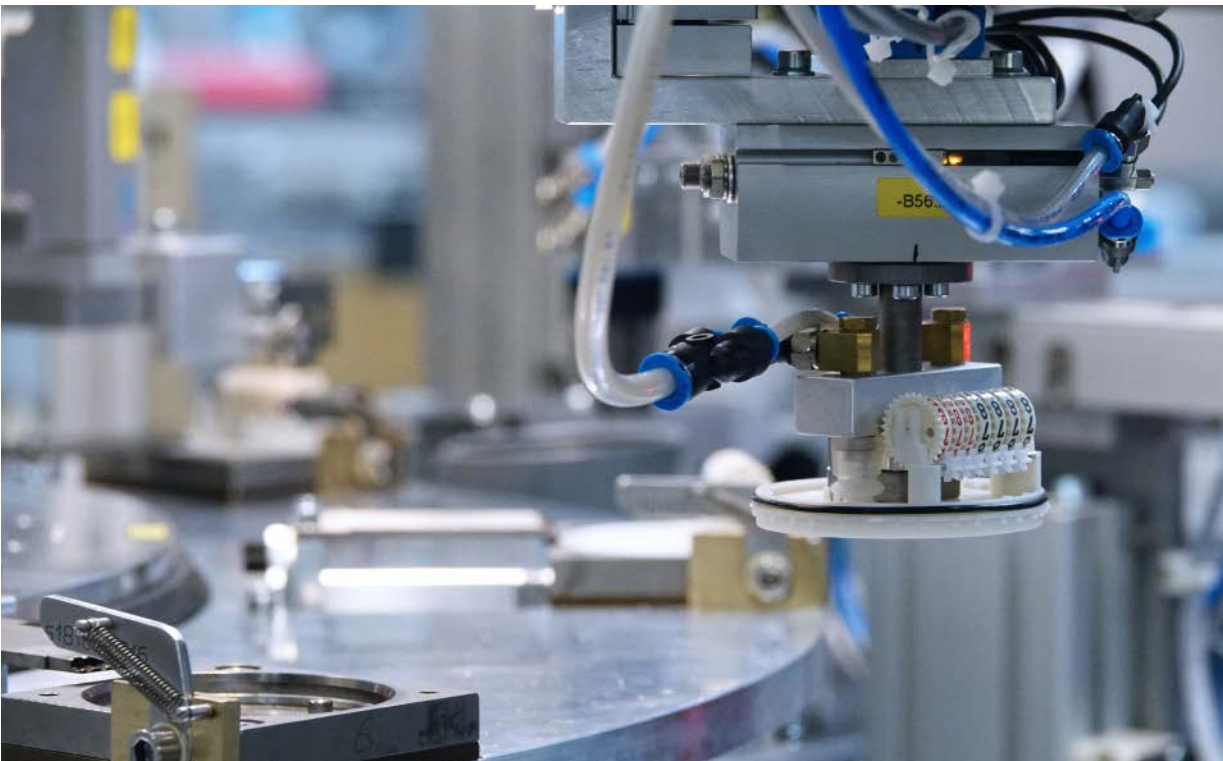
› Erfolgreiche Installation mit „doppeltem Boden“: Die Unternehmenstochter REX Automatisierungstechnik ersetzt die Steuerung einer Prüfanlage für Wasserzähler, die bereits 26 Jahre im Einsatz war. Bei der Testung der elektrischen Ausrüstung inklusive Steuerungstechnik gewährleistete das REX AT-Team im Probebetrieb der Installation die Möglichkeit, auf das bestehende, alte System umzustellen.
