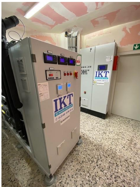
Bild 3: Blick in die Kältezentrale mit Booster-System von Arneg im Vordergrund und Schaltschrank mit Virtus 5 Systemzentrale im Hintergrund (Foto: IKT / Arneg)
