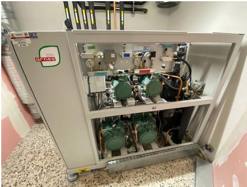
Bild 2: Booster mit 2 NK und 2 TK-Verdichtern (Foto: IKT / Arneg)
