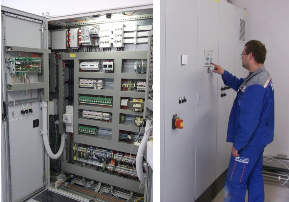
Abb. 1: Schaltschrank mit neuer VS 3010 CT (links in der Tür) und Kältemonteur bei Einstellungen am Marktrechner CI 3000. (Fotos: Dresdner Kühlanlagenbau GmbH)
