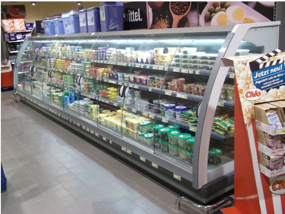
Abb. 2: Verglaste NK-Kühlmöbel im Edeka Behringen (Foto: Dresdner Kühlanlagenbau GmbH)
