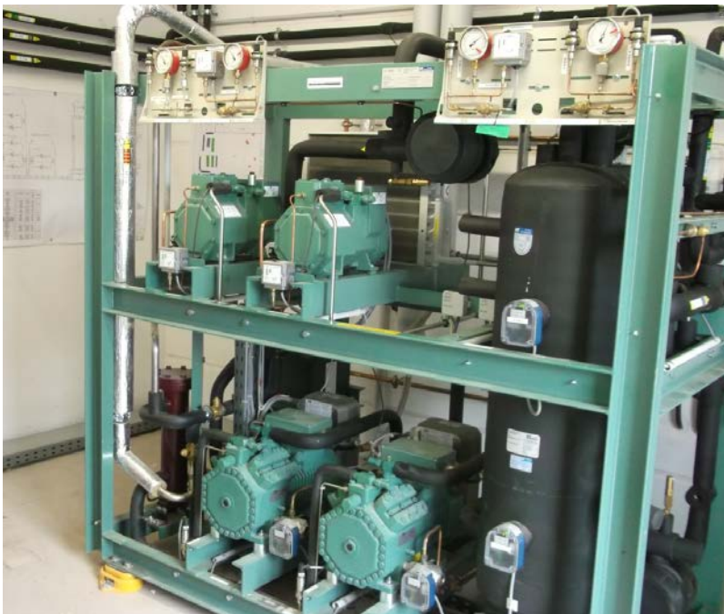
Abb. 3: TK/NK-Verbund mit jeweils 2 Verdichtern und Wärmerückgewinnung (Foto: Dresdner Kühlanlagenbau GmbH)
