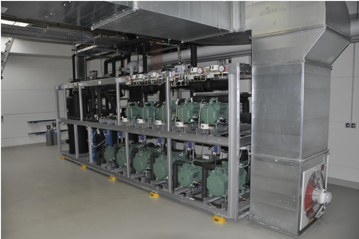
Abb. 1: Blick unter die „Motorhaube“ der Kälteanlage. (Foto: Meilbeck)
