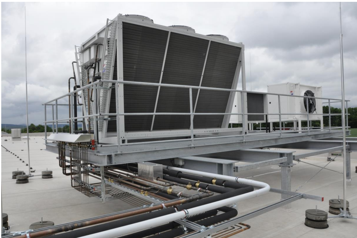
Abb. 4: Gaskühler mit 350 kW Verflüssigungsleistung. (Foto: Meilbeck)
